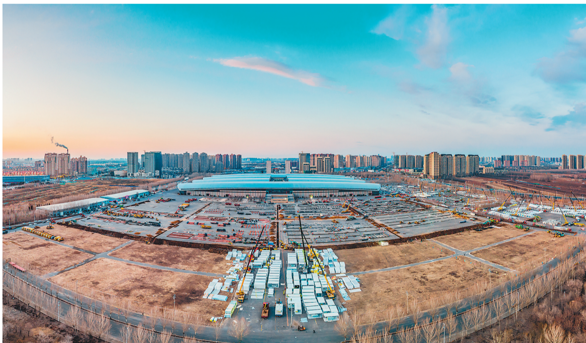
图为无人机拍摄的沈阳方舱医院应急改造工程和健康驿站工程建设场景。
