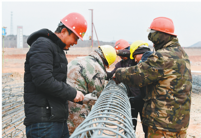
九州国泰(朝阳)新材料有限公司年产30万吨方矩管生产项目正在积极建设中。
