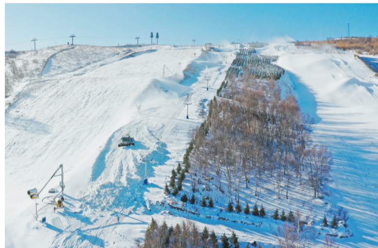
11月16日,工作人员驾驶机械设在云顶滑雪公园平整雪道(无人机照片)。近日,北京冬奥会张家口赛区云顶滑雪公园看台座椅已安装完毕,工作人员忙着对赛道进行二次塑型等工作,为即将到来的测试赛做准备。
