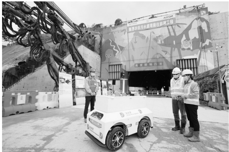
25日，由香港特区政府、香港中联办、中国建筑集团共同主办的“时代精神耀香江”之大国建造系列活动在港开幕。5天来，4位内地知名建筑专家走进大学校园，举办“大国建造·筑梦未来”校园报告会，与香港学子互动交流，中国建造的辉煌成就博得同学们阵阵掌声。图为10月28日拍摄的搬迁沙田污水处理厂旧岩洞工程工地。新华社记者 吕小伟 摄
