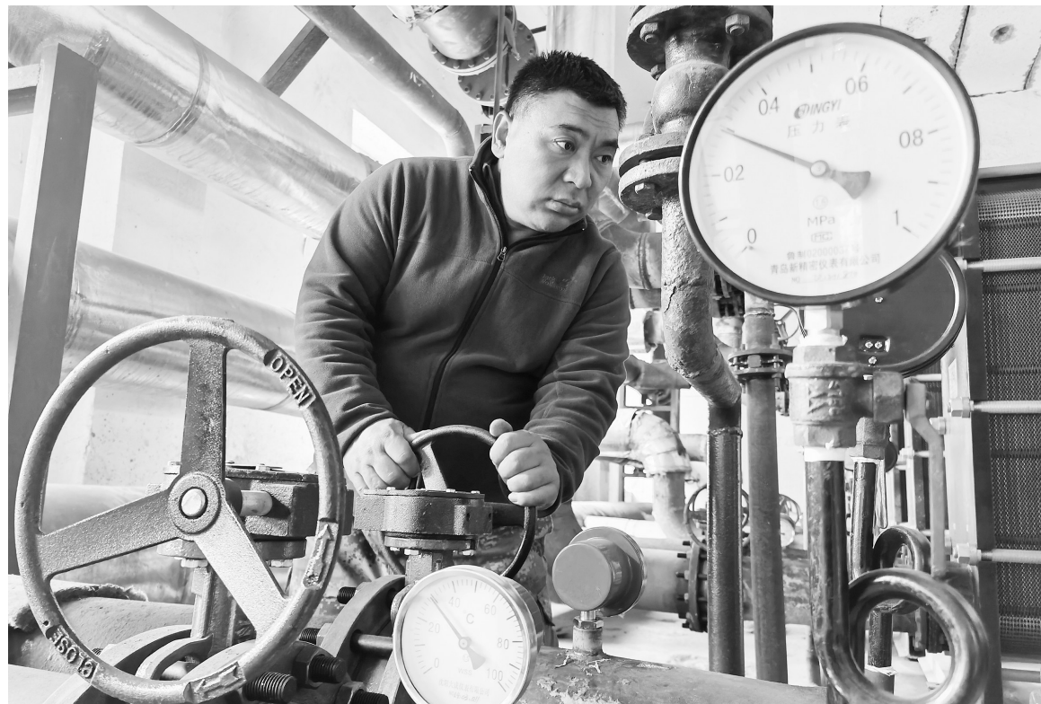
换热站工作人员在调节换热器阀门。
