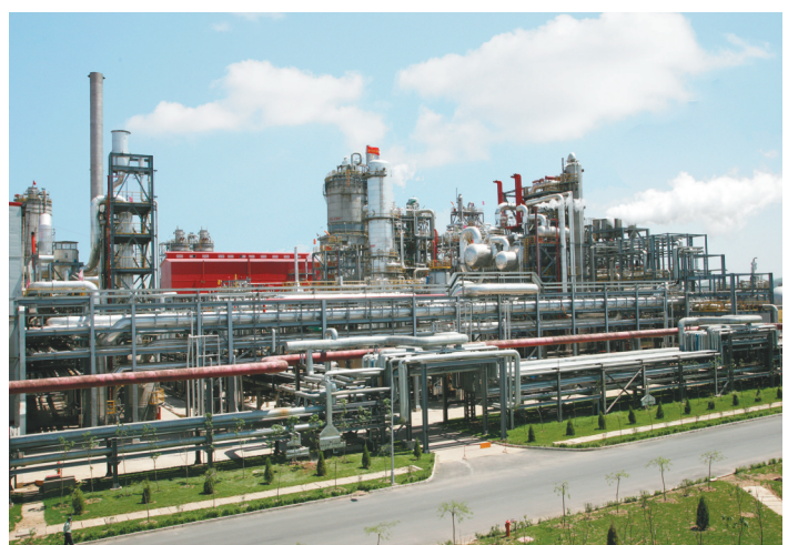
辽阳石化80万吨PTA装置。
