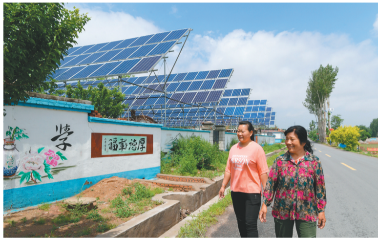
国营朝阳县贾家店农场光伏电站项目。
