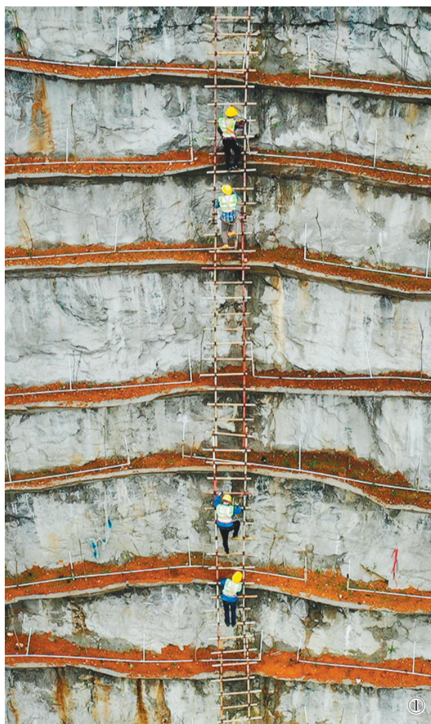
在广西柳州市梯梯山山体复绿工程施工现场,有一群忙碌在峭壁上的“植绿人”。他们通过搭建钢筋混凝土V型槽和混喷的方法,在陡峭的石头山上开辟出了一片片“梯田”,回填泥土后种植石山紫薇、夹竹桃、三角梅等进行绿化,并在“梯田”搭建供水供养料的管道,以利于植物生长。经过工人们的努力,梯梯山山体重新披上绿装。
