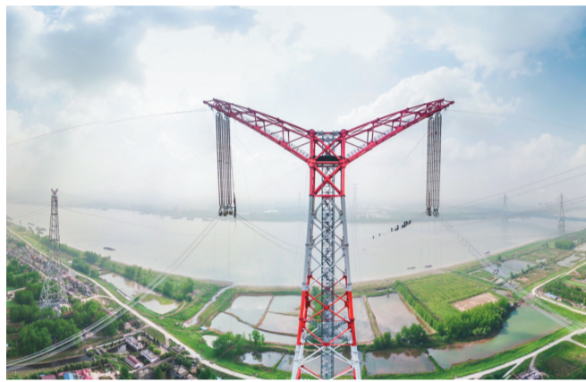
图为西电东送±1100千伏“新疆准东—安徽皖南”特高压直流工程位于长江北岸的跨越塔。
