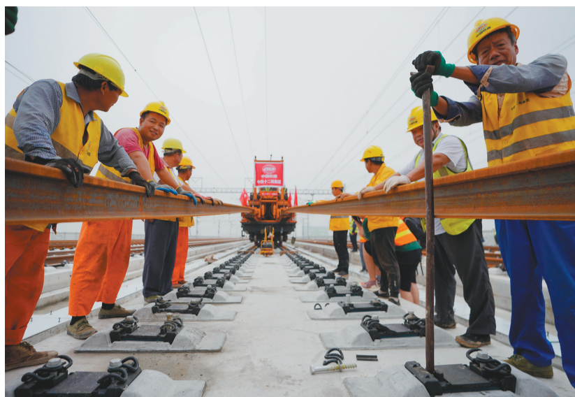
图为中铁十二局的工人在安装京雄城际铁路最后一组钢轨。新华社发
