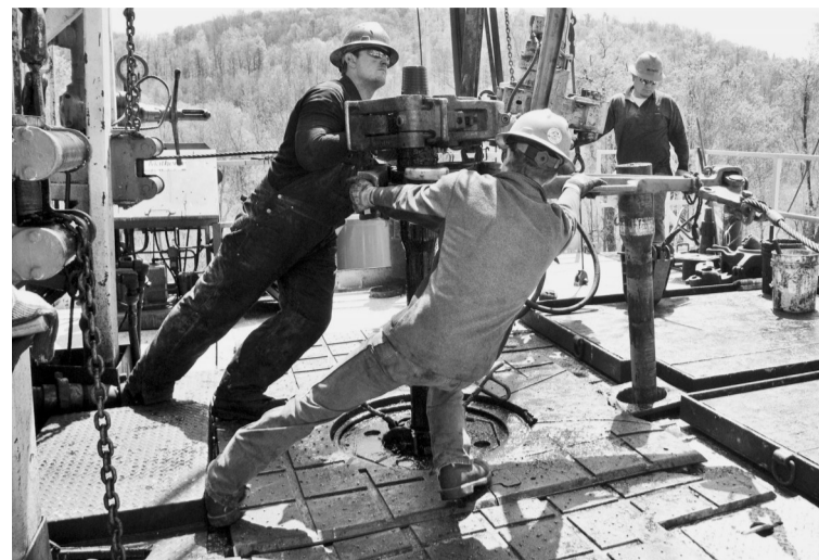
图为2010年4月23日在美国宾夕法尼亚州布拉德福德县拍摄的切萨皮克能源公司的钻井平台与工人。美国老牌页岩油气企业切萨皮克能源公司28日发布新闻公告说,公司已向得克萨斯州南区破产法院申请破产保护进行资产重组。切萨皮克能源公司公布的季度财报显示,今年一季度,公司营业收入超25亿美元,净亏损约83亿美元。切萨皮克能源公司创立于1989年,鼎盛时拥有175个钻机。 新华社发
