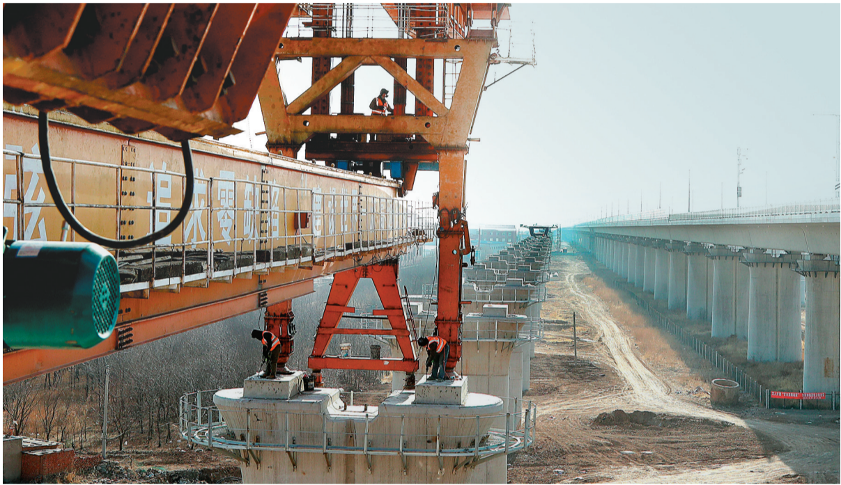
3月14日，在中铁十九局承建的朝凌客专TJ-1标什家子河特大桥施工现场，高铁建设者正在进行架梁作业，呈现出一派繁忙的复工景象。据了解，中铁十九局朝凌客专项目部在做好疫情防控的基础上，有序复工推动项目建设加快推进。截至目前，朝凌客专TJ-1标首批复工的工人已经达到1100多人，复工率达到90%以上。 本报特约记者 李松娟 摄
