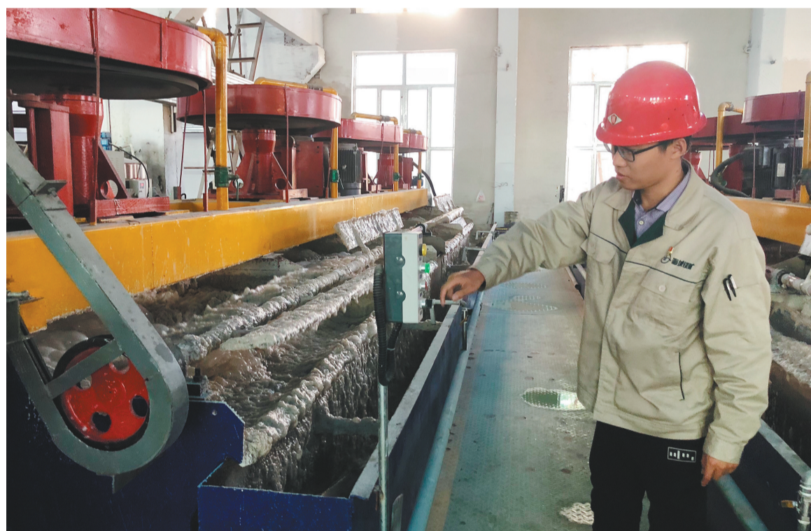
技术人员正在使用刚刚改造升级的选矿设备。
