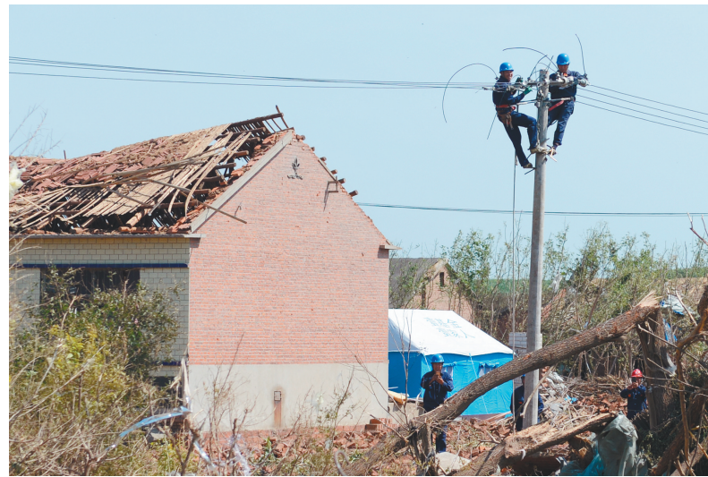
7月6日,在开原市兴开街道瓜台子村,电力部门正全力以赴抢修供电设施,尽快为遭受龙卷风侵袭的村民恢复电力供应。 本报记者 徐丹伟 摄
